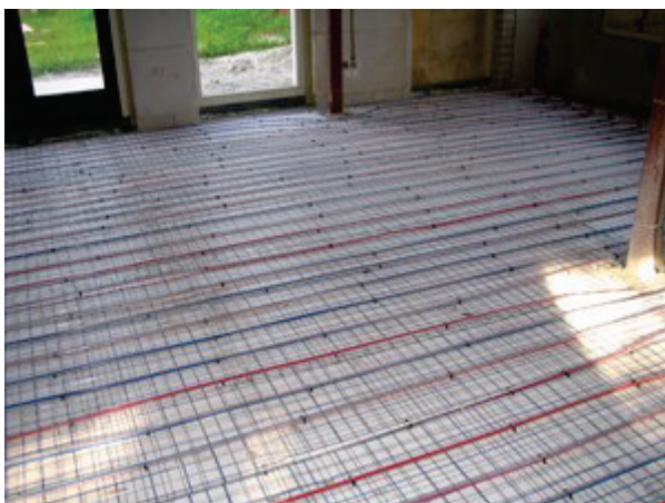
Afb. 8.2 Het afgiftesysteem voor vloerkoeling is hetzelfde als voor vloerverwarming. Een systeem met direct een isolatielaag er onder reageert veel sneller dan een systeem zonder die isolatie (zie ook paragraaf 7.2.3). Op de foto moet de dekvloer nog worden aangebracht
