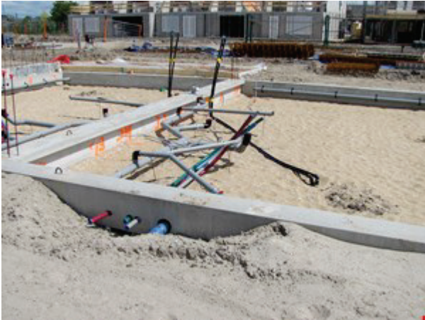
Afb. 7.22 Rechts op de voorgrond, tussen de funderingsbalken, is de aansluiting (zie de twee zwarte leidingen) met de verticale bodemwisselaar te zien. De foto is genomen in RijswijkBuiten in Rijswijk (ZH)
