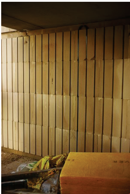
Afb. 7.9 Warmtewand in aanbouw. De prefab sleuven kunnen zowel verticaal als horizontaal lopen, dit hangt af van het merk van de elementen. Horizontaal lopende leidingen hebben als voordeel dat ze eenvoudiger te ontlichten zijn; nadeel is dat de stenen qua draagkracht (door de horizontale sleuven) niet optimaal gebruikt worden
