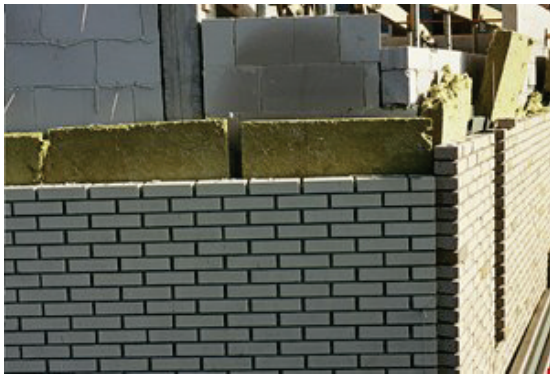
Afb. 5.22 Zorgvuldige uitvoering voorkomt energieverlies. Op de foto is duidelijk zichtbaar dat de isolatieplaten niet op elkaar aansluiten waardoor een ernstig warmtelek zal ontstaan.
