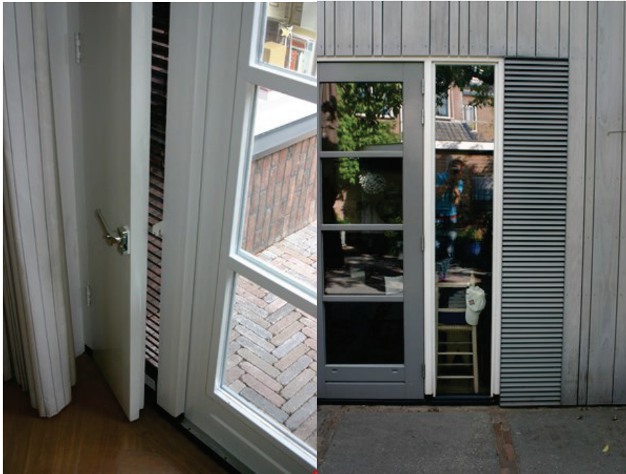
Afb. 6.23 Voorbeeld van een voorziening voor zomernachtkoeling in een woning te Zeist. In de gevel van de woonkamer zijn 2 inbraakvrije ventilatieroosters ( 2 \times 0,25 \times 2 \text{ m} = 1 \text{ m}^2 ) met een isolatieluik aangebracht; een dakraam zorgt voor een goede natuurlijke trek. (Betrokken partijen: Architect ii studio, realisatie Ettehoven Annemer & interieurbouwer, advies BOOM-SI; realisatie 2009. Foto's: Joost Ettehoven)
